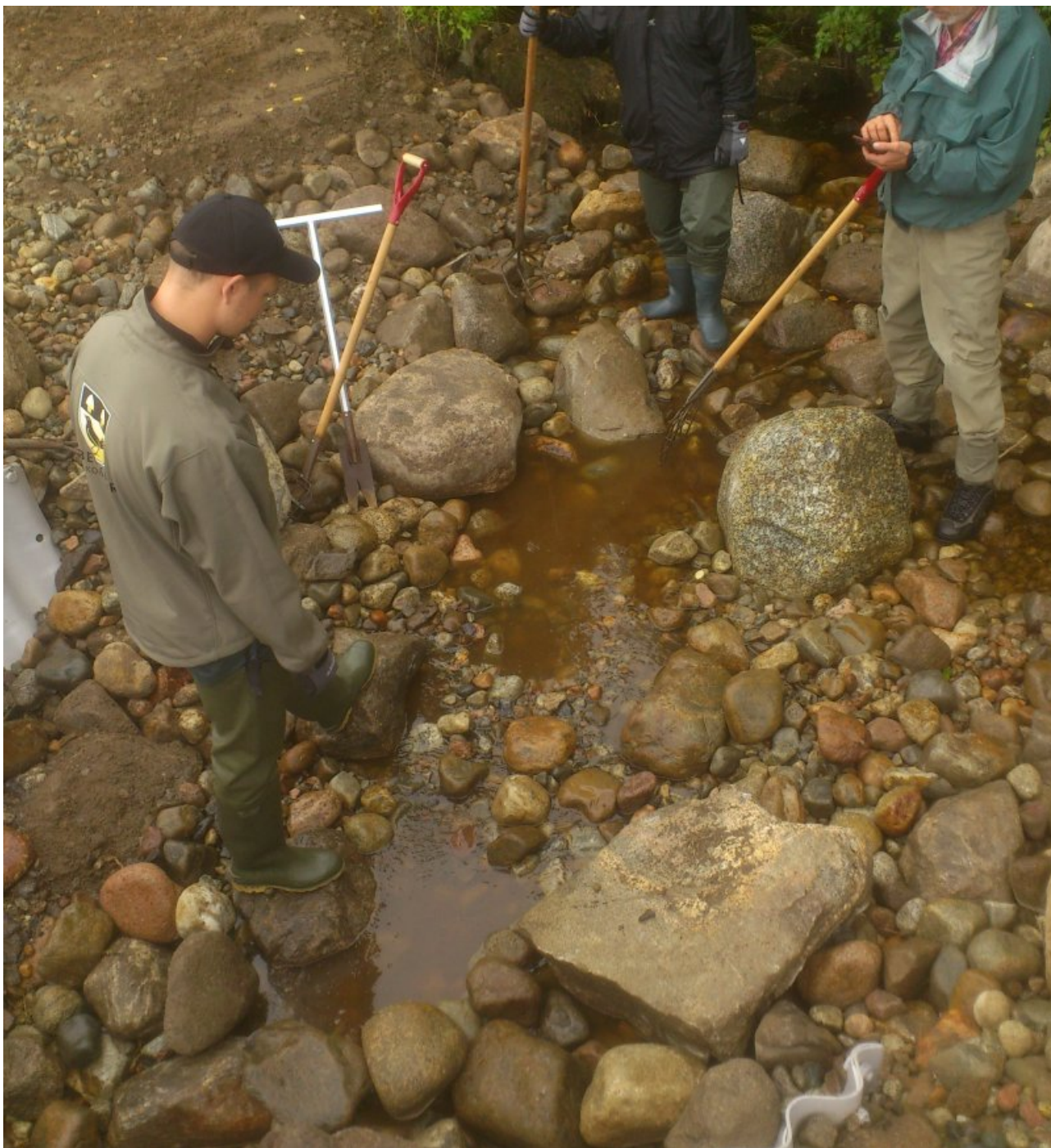
Two lekbottnar byggdes vid den nya trumman i Aftonmorväcken. Därtill flyttades stenar inne i den nya trumman, så att en fullt fungerande fåra bildades.
